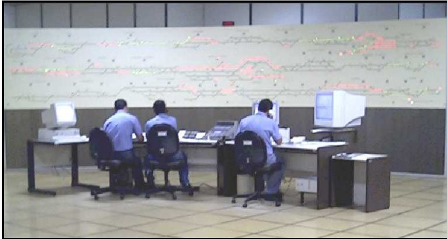
Figura 14: Centro de Controle Operacional
