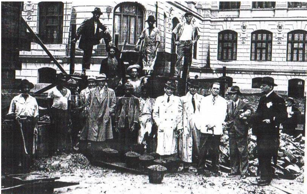
Figura 4 – Milton e Marcelo Roberto no canteiro de obras da ABI (os arquitetos são os que vestem sobretudos claros)
