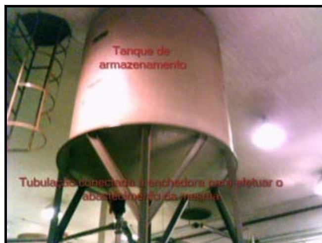
Figura 4 – Tanque de armazenamento
