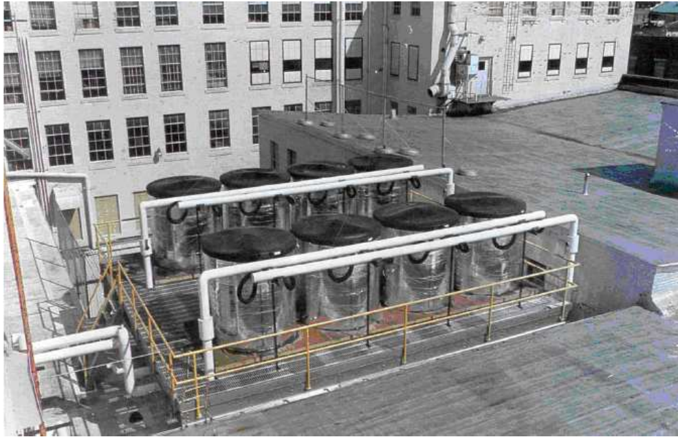
Figura 2.5: Sistema com Termoacumulação - Banco de gelo - Aplicação em uma unidade comercial - Fonte: Jamil Haddad - Apresentação CPFL.
