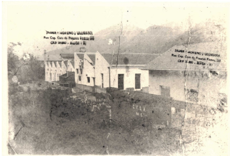
Figura 24 - Início das obras de remodelação do prédio da fábrica Esther, imediatamente após em março de 1941. Fonte: autor desconhecido. Acervo de Sônia Maria Gonzaga de Oliveira
