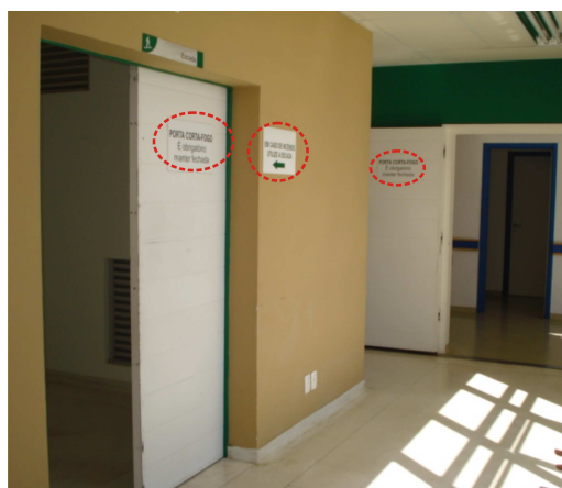
Figura 65 – Alerta para o uso da escada em caso de incêndio, e informações indicativas das portas corta-fogo.
