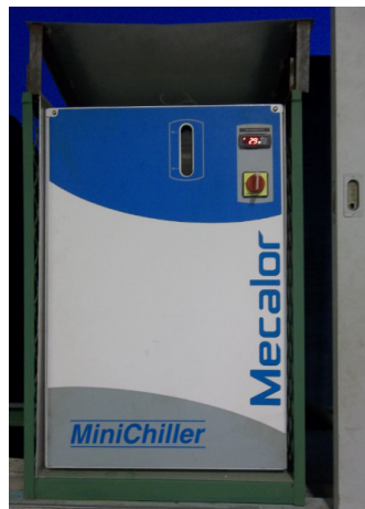
Figura 3.9: MiniChiller utilizado para resfriar o compressor de gás Hélio.
