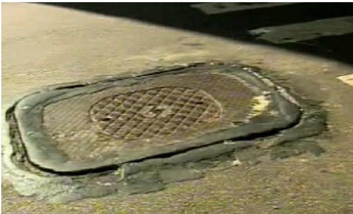
Figura.9.1 Explosão Bueiro em Copacabana. 30/06/2010 – Equipe RJTV
