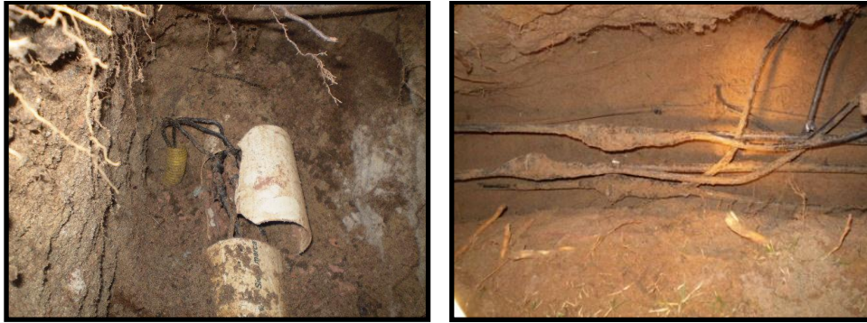
Figura 2.7: Irregularidade na rede subterrânea.
