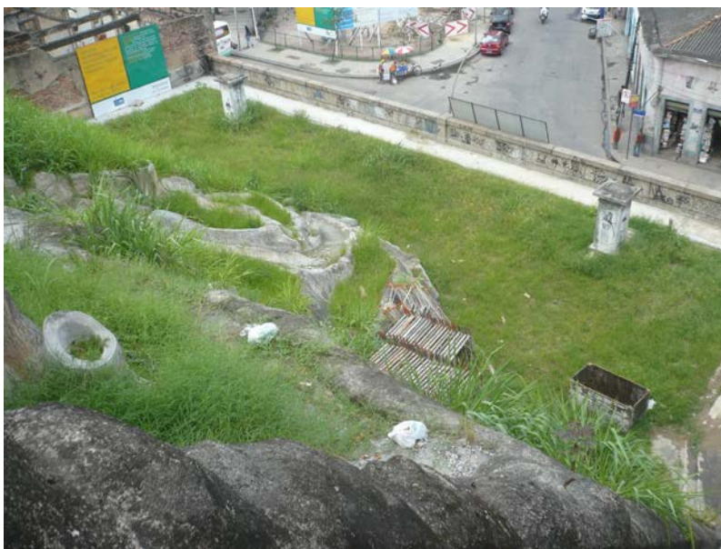
Vista parcial do Jardim Suspenso do Valongo em 2011, antes da revitalização: mato crescendo, abrigo para populações de rua e, no detalhe, pedestais vazios de deuses Greco-romanos. Foto do autor.
