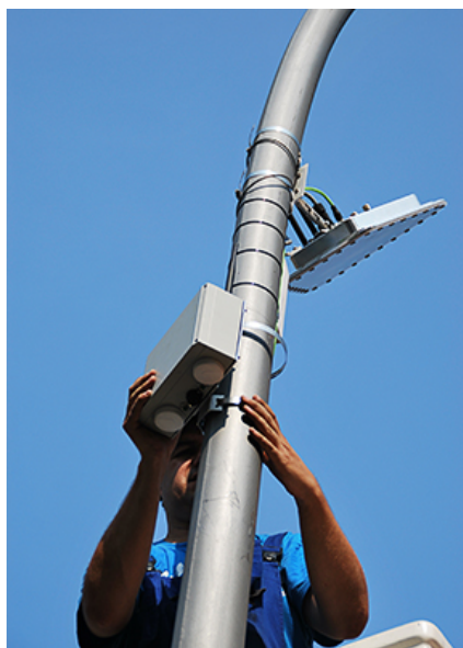
Figura 5.1: Instalação de um sensor Siemens para monitorar vagas de rua em Berlim - Alemanha. Fonte: www.siemens.com
