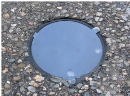
Figura 5.2: Um sensor de vaga de estacionamento instalado no asfalto no centro de Los Angeles. Fonte: www.laexpresspark.org
