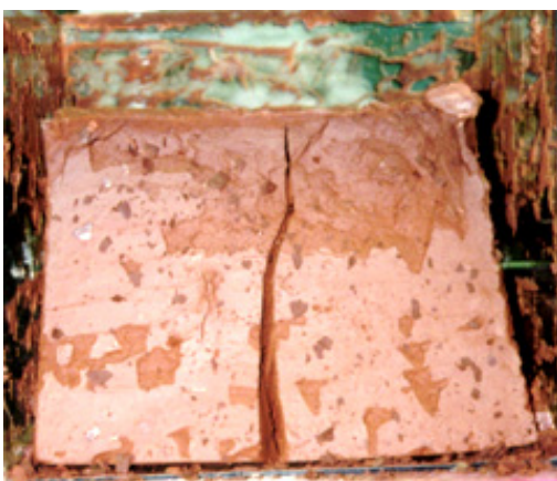
FIGURA 8.53: Trinca Com Maior Abertura na Base – Contração Lateral Diferenciada.
