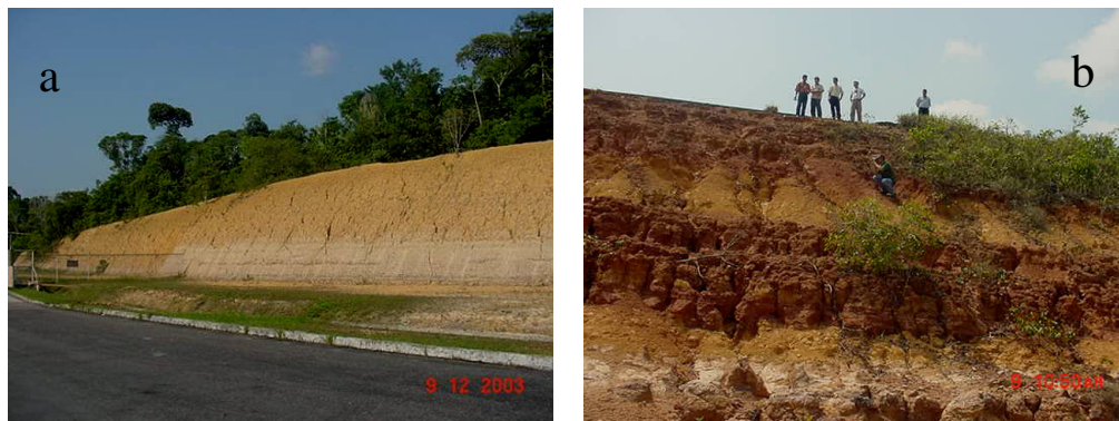
Figura 2-3 Taludes de corte desprovidos de vegetação apresentando erosão em sulcos e ravinamentos em talude do Aeroporto Internacional Eduardo Gomes (Manaus/AM) (Andrade, A.G.; Demonte, R.F.; Acervo Fotográfico/Convênio Embrapa/INFRAERO).
