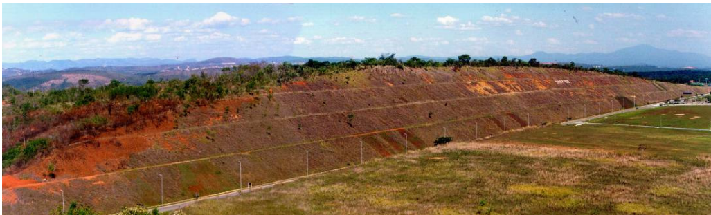
Figura 2-2 Talude do Eixo Viário no Aeroporto Internacional Tancredo Neves (Confins/MG) (Andrade, A.G.; Capeche, C.L. Acervo Fotográfico/Convênio Embrapa/INFRAERO).
