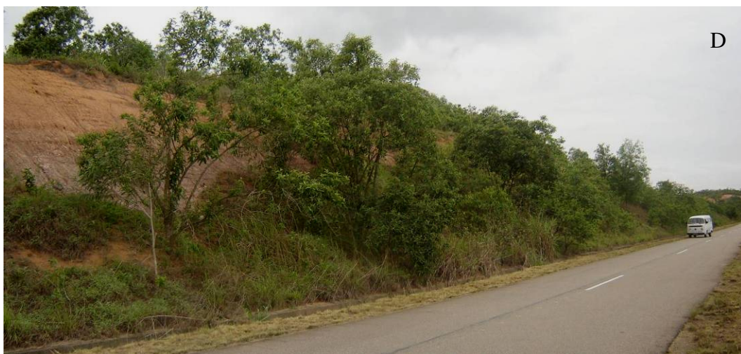
Figura 2-30 A – (Talude B) próximo ao corpo de bombeiros, do outro lado da pista. B, C (Talude C) também próximo com seção expondo a Formação Macacu. D (Talude D) de corte degradado na via de serviço que margeia a cabeceira 28 próximo à Área Z.
