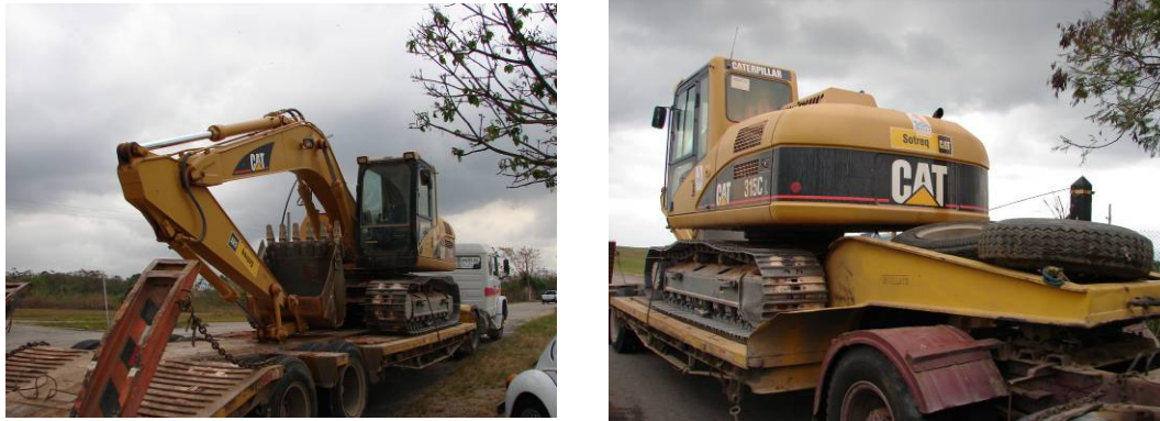
Figura 2-36 Escavadeira Hidráulica CAT 315C-L utilizada nas obras do Talude da Área Z.
