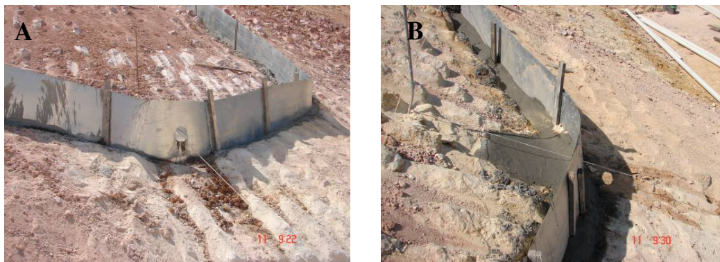
Figura 2-65. A – emboque da Parcela I visto de frente. B – vista por dentro da rampa de aproximação em concreto visando direcionar os sedimentos e evitando o entupimento.
