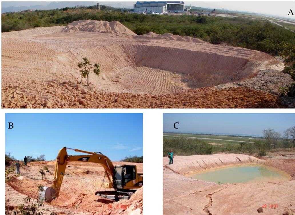
Figura 2-49 Bacia III: (A) logo após seu término; (B) durante o processo de construção; (C) depois das primeiras chuvas (29-10-07).
