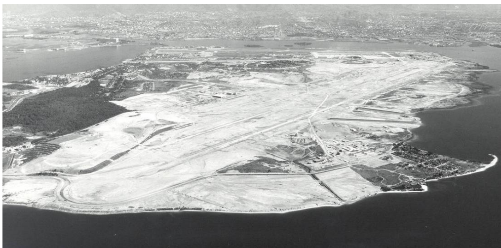
Figura 2-1 Obras de terraplenagem e aterramento para a construção do Aeroporto Internacional do Rio de Janeiro Galeão/ Tom Jobim. Observa-se que as obras envolveram grande parte da Ilha do Governador, modificando completamente seu relevo.
