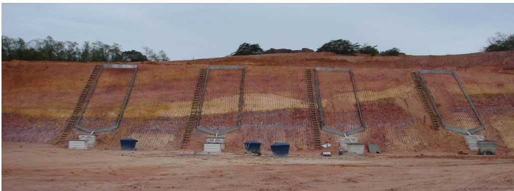
Figura 2-69 Vista frontal das Parcelas na fase de acabamento final logo após uma chuva.
