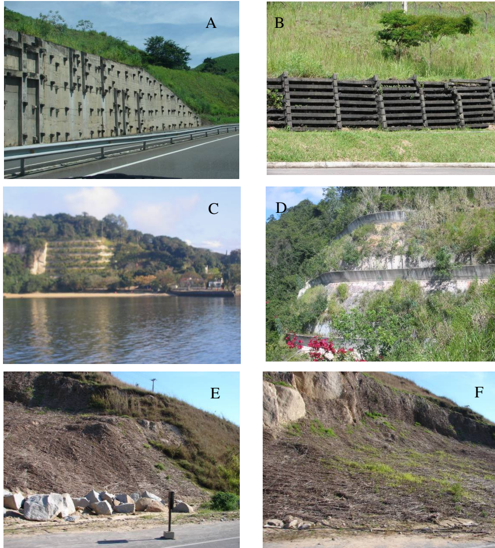
Figura 2-73 A - cortina atirantada na Rodovia Rio Juiz de Fora. B - controle biotécnico com reaproveitamento de moirões de concreto deixando a vegetação crescer dentro (na mesma rodovia). C – Controle biotécnico em talude de corte (Paqueta-RJ). D – Detalhe das jardineiras chumbadas na pedreira visando o recobrimento vegetal e trazendo um aspecto paisagístico. E - Biomanta logo após instalação em talude de corte na Rodovia Rio Santos (altura de Parati). F – vegetação brotando e atravessando as biomantas em talude próximo.
