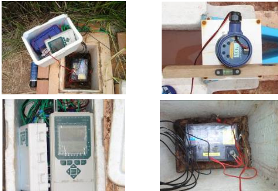
Figura 4-67 Instalação do Logger ALMEMO® 2890-9 em campo para aquisição dos dados do LU-20.
