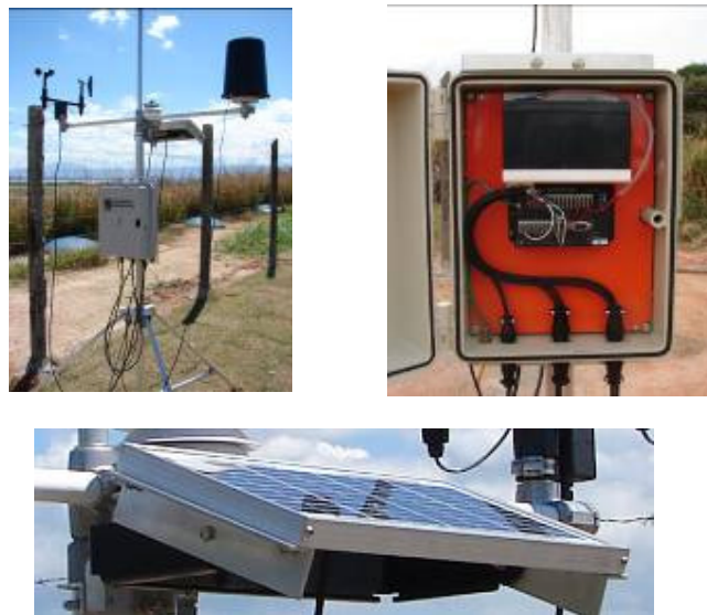
Figura 4-8 Estação Meteorológica Compacta Campbell, destacando-se o abrigo para sistema de aquisição de dados e o Painel Solar.
