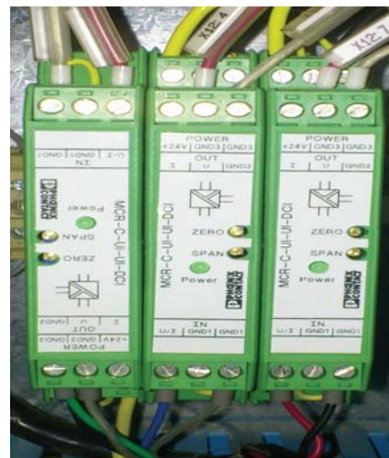
Figura 3.31: Módulos isoladores de sinais analógicos utilizados nos cabos de comando e controle.
