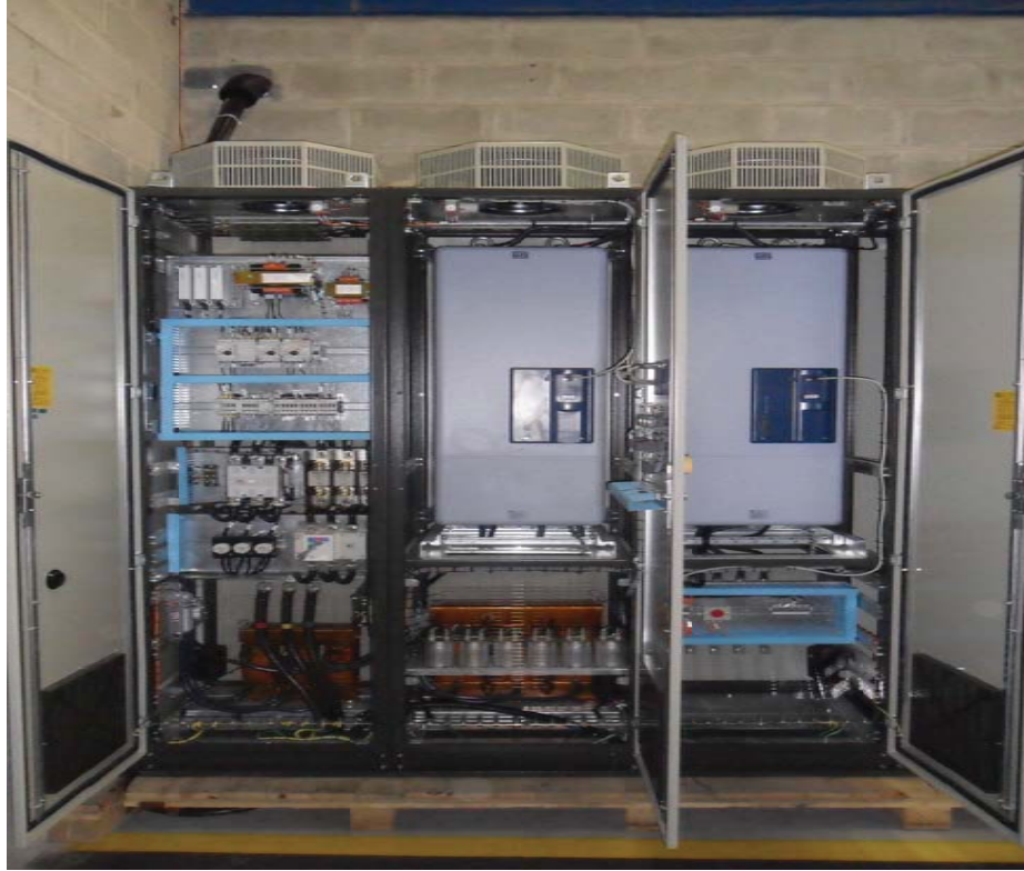
Figura 3.23: Painel com inversor de frequência regenerativo instalado no laboratório.
